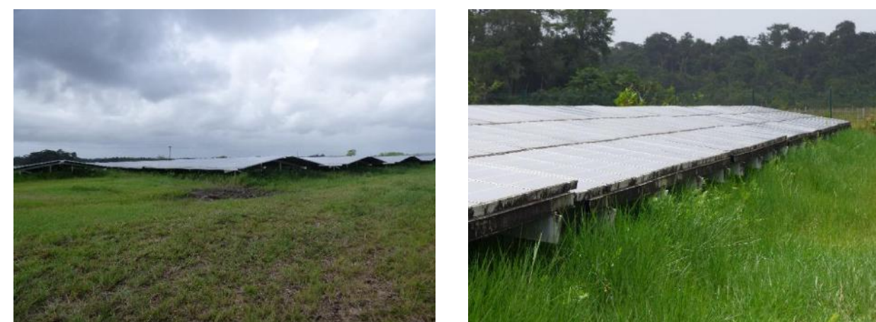
Fig. 9. Vue de l'installation réalisée (tranche 1)
