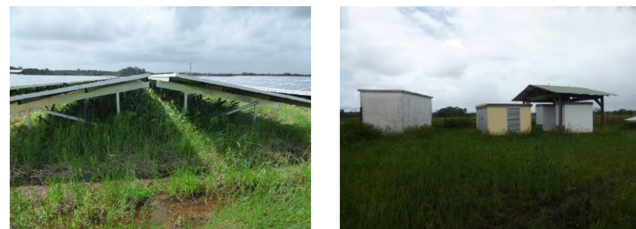
Fig. 10. Vue de l'installation réalisée et locaux technique (tranche 1)
