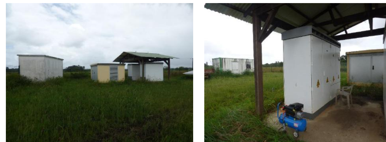
Fig. 17. Locaux technique de la tranche 1
