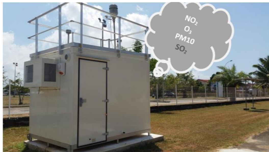
Fig. 56. Station fixe de mesures à Kourou( source : ATMO Guyane)
