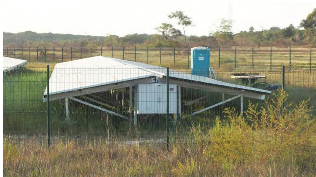
Fig. 13. Vue de l'installation existante
