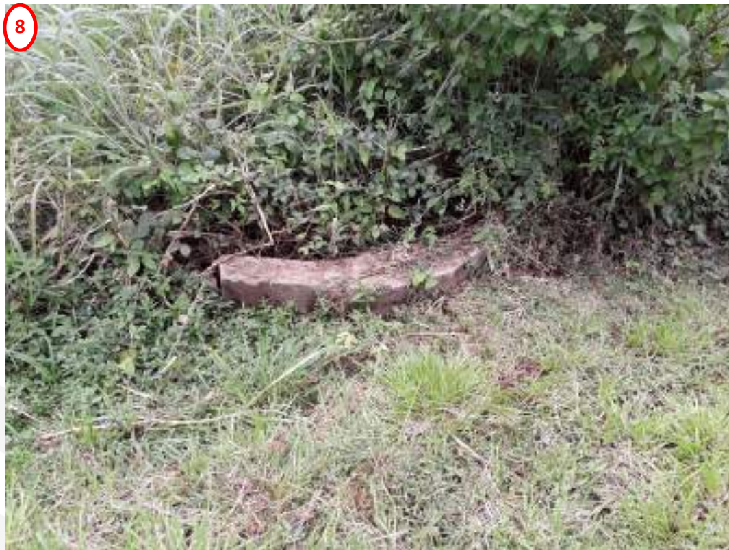
Figure 7: Tête de rejet central, dans l'axe de l'écoulement repéré au nord du talus de stockage (Suez consulting Février 2022)
