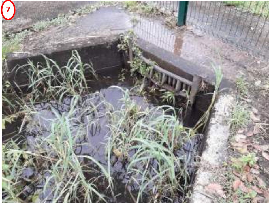
Figure 6: Tête de rejet sur la partie aval, dirigé vers la mer (Suez consulting Février 2022)
