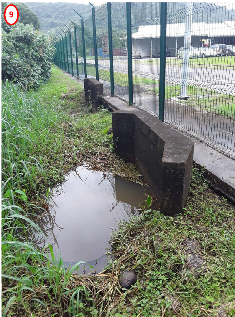
Figure 8: Têtes de rejet Nord, dans l'axe de la ravine (Suez consulting Février 2022)
